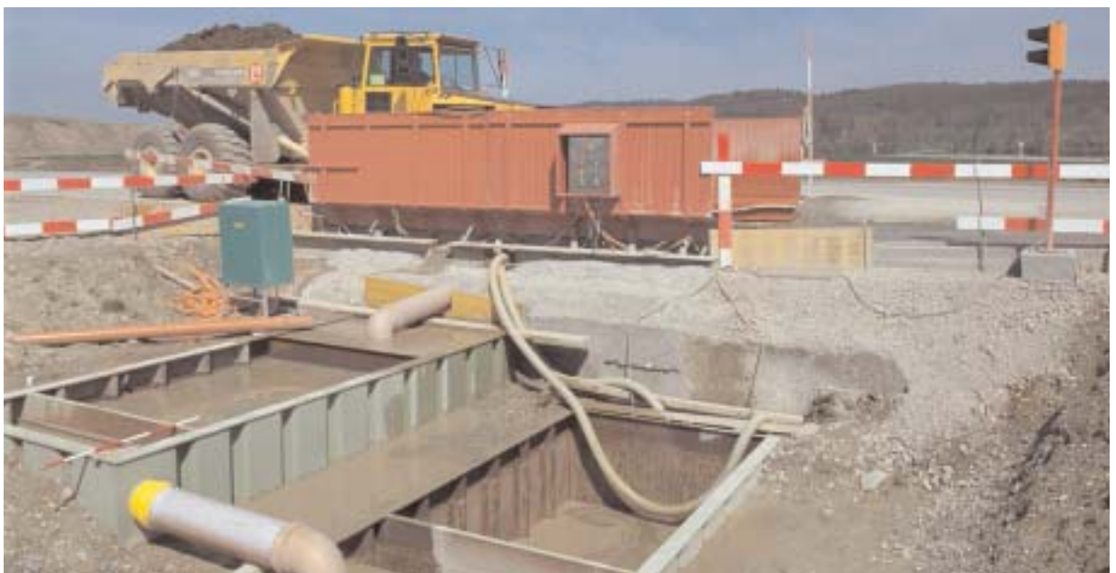
Abb. 1: Behandlungsanlage für Baustellenabwasser
